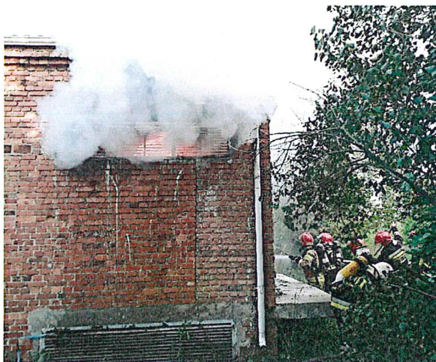
31.05.2020 r.- pożar budynku stacji transformatorowej w Koluszkach ul. 3-go Maja - 4 zastępy JRG – 8 strażaków, - 1 zastęp OSP – 7 strażaków.
